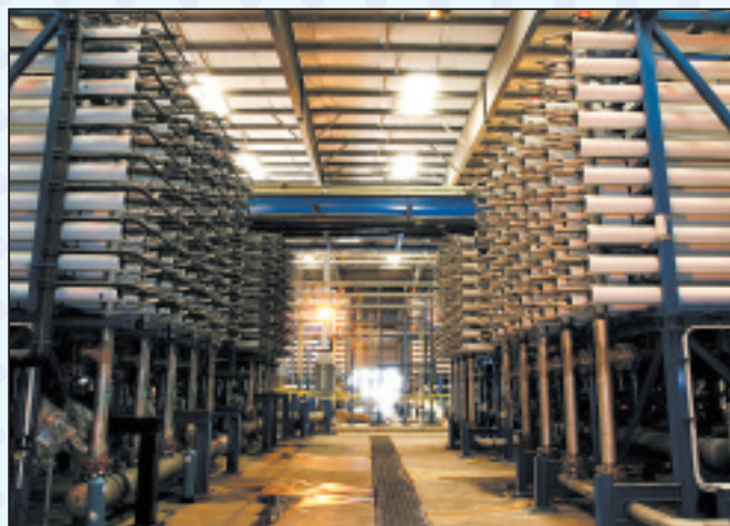
西半球最大の海水淡水化プラント(トリニダード・トバゴ)
